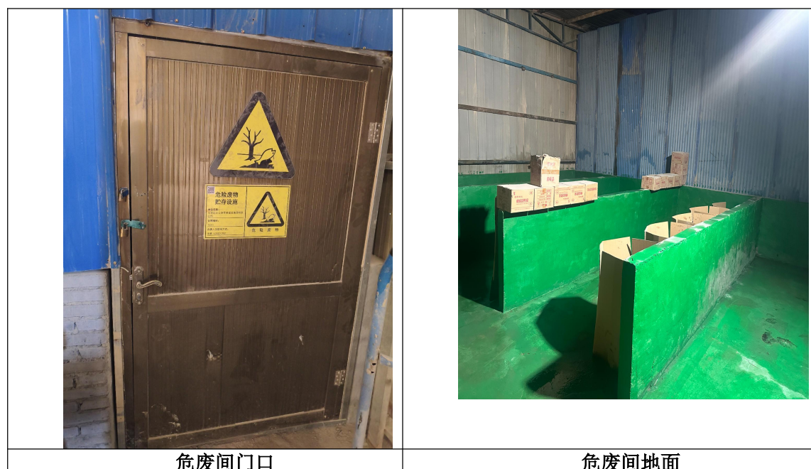
图 4-3 现有危废暂存间现场照片
